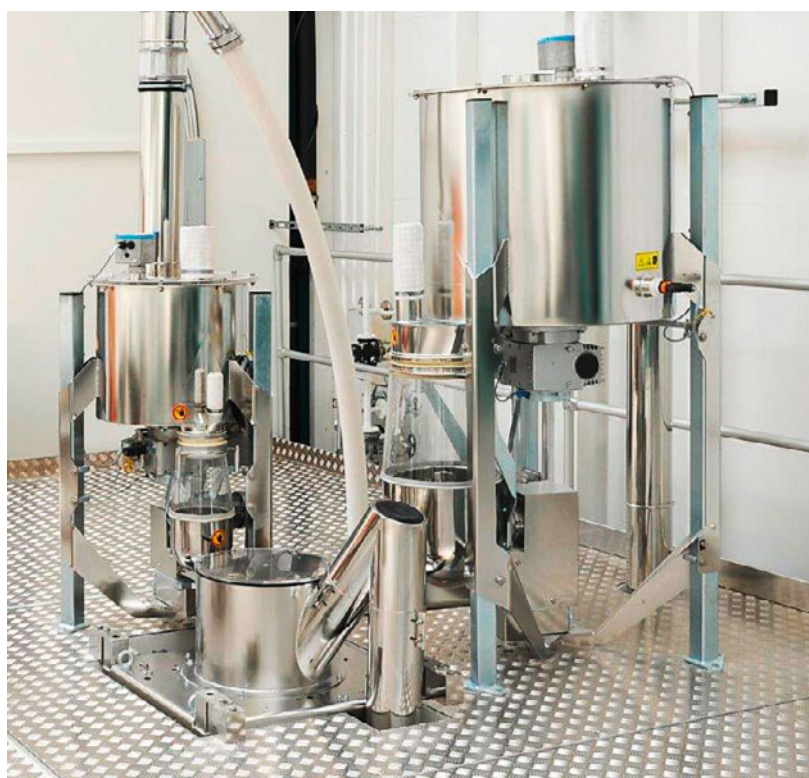
«Bühler Dosiergerät installiert.»
