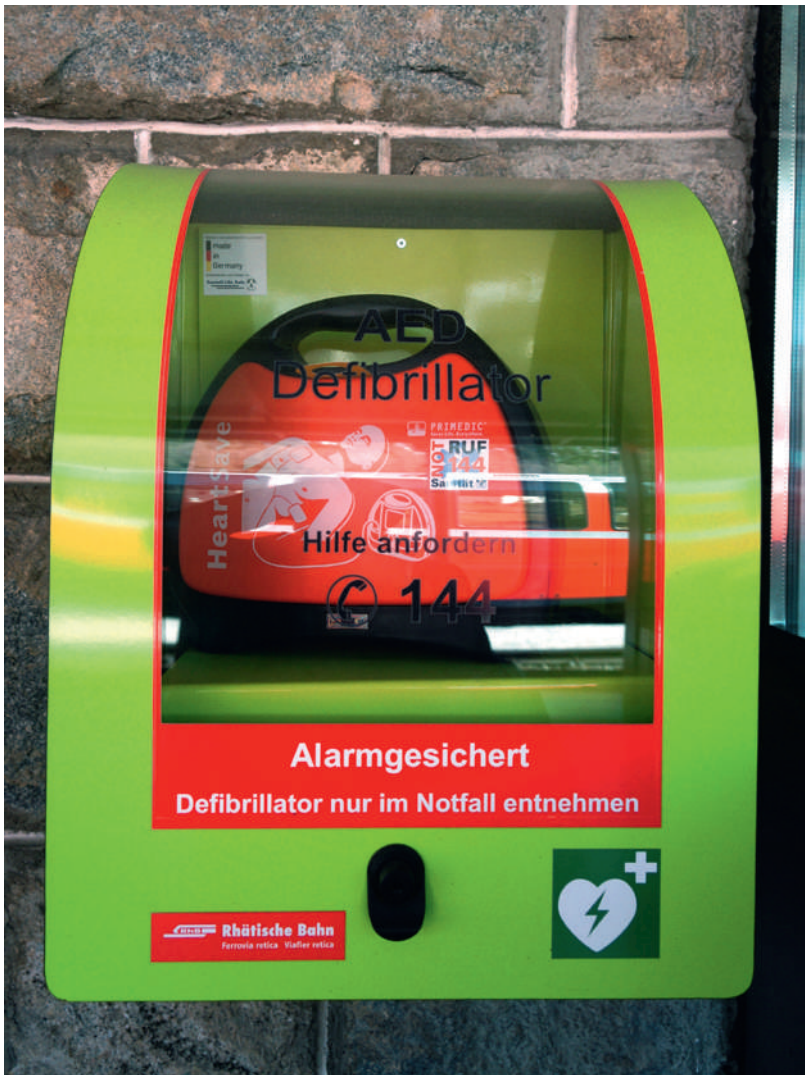
Grâce au défibrillateur externe automatisé installé dans la gare de Saint-Moritz, les gens peuvent sauver des vies.
